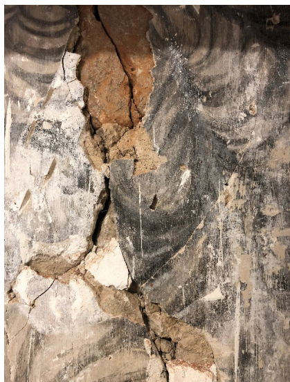
Figura 7. Detalle de grieta y estado de soporte
