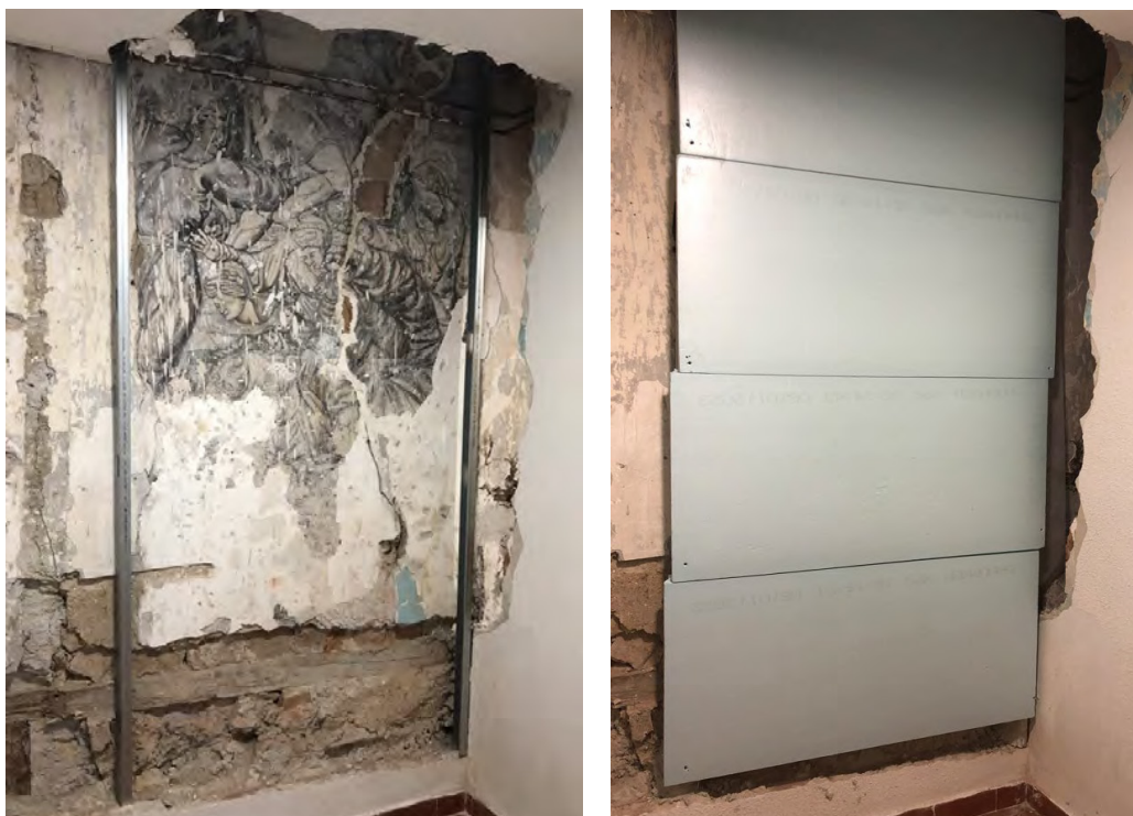
Figura 11. Estructura de protección de las pinturas
