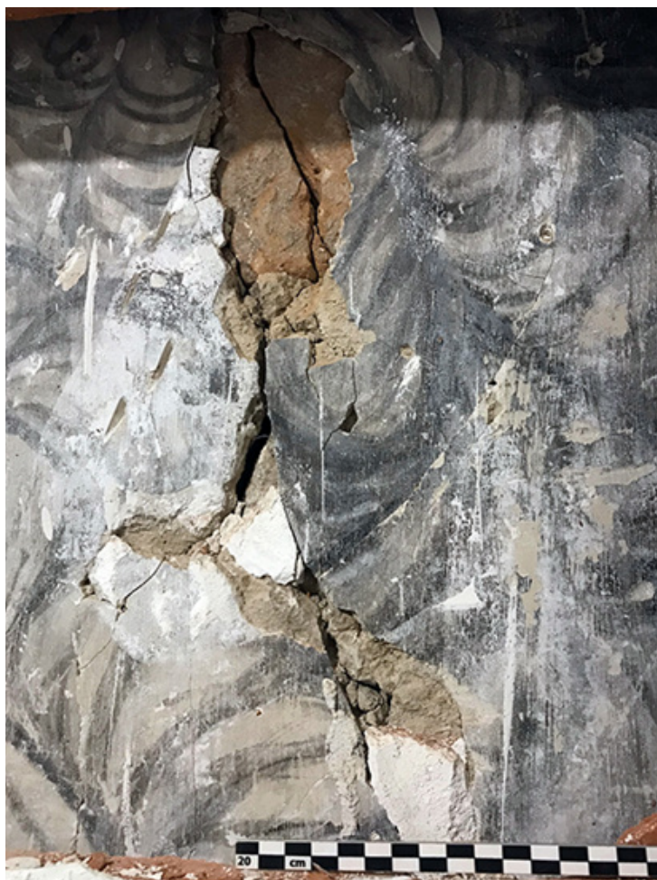
Figura 12. Pérdida de material en la superficie.
